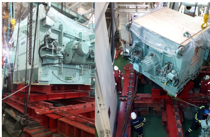
Deslizamiento de alternador
